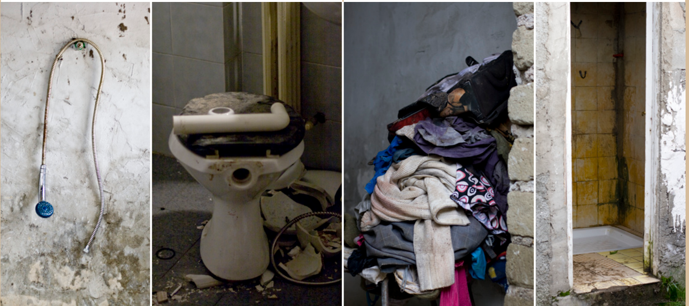
Ansichten aus Toiletten- und Waschräumen in der Comunità la pace in Rom & der Casa Bianca in Turin
